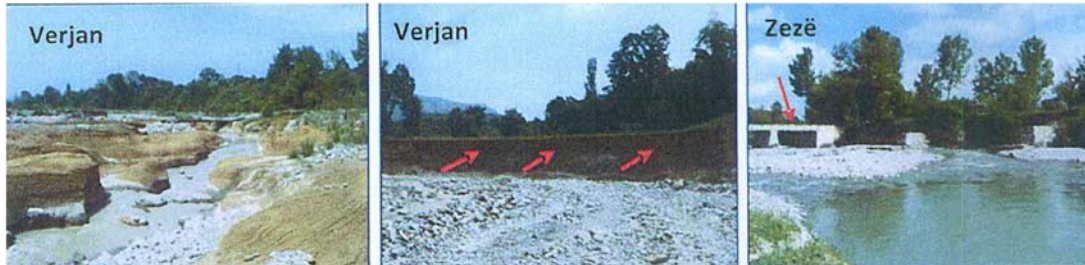
Fig. 35: Deformime shtratore, erozion i brigjeve dhe rrezikim i objekteve inxhinierike
